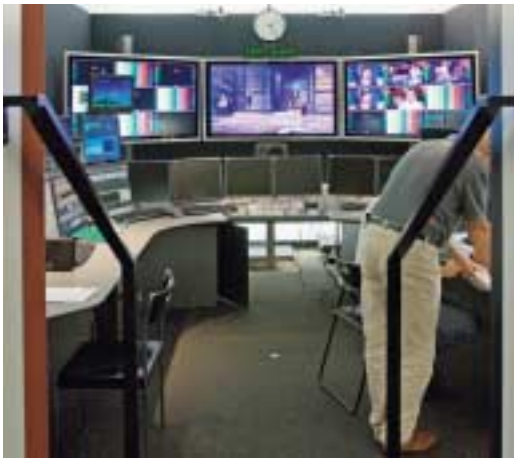
Die neue Senderegie bildet das Herzstück der neuen Installationen. Von hier aus werden sämtliche HD-Sendungen gesteuert
